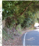
27 瀬戸内 道路側面のシラス が崩れていて危険
