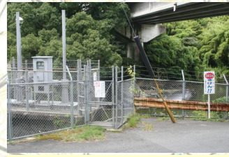
22 大田下 発電所付近の川 水門、岩場、高压電線 あり、危険
